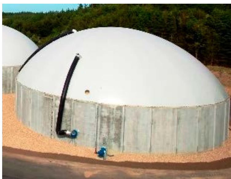
Figur 21: Lager tank med gaslager på toppen.
